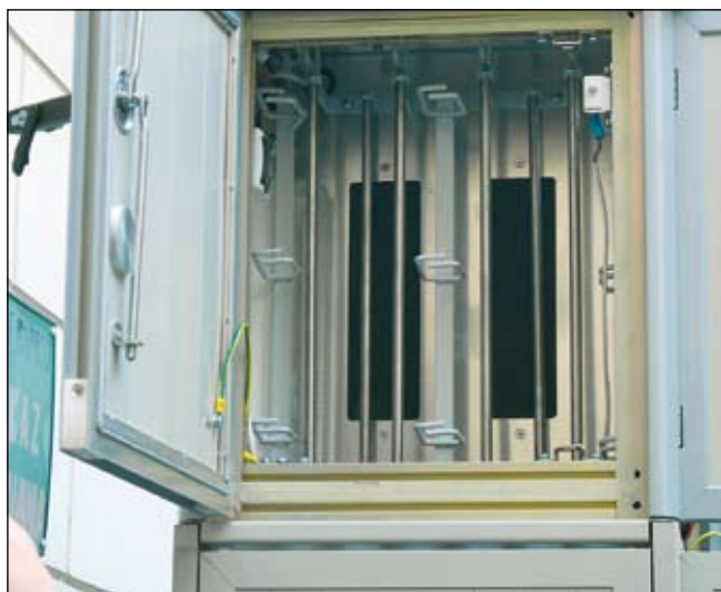
Шкаф после реконструкции
