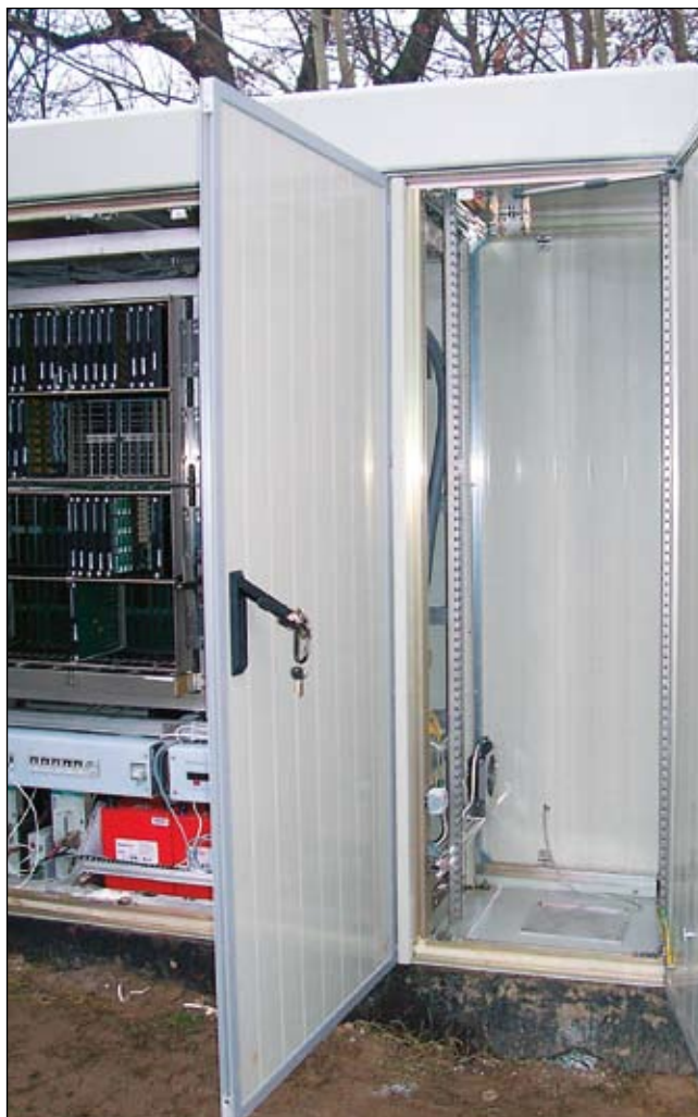
Шкаф после реконструкции
