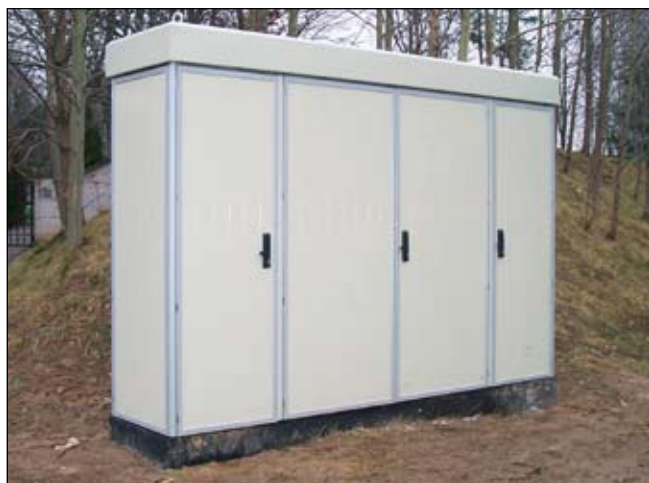
Шкаф после реконструкции
