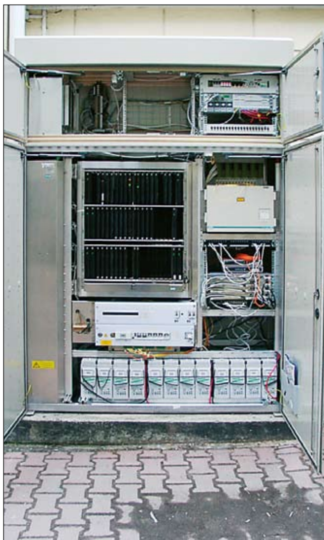
Шкаф после реконструкции
